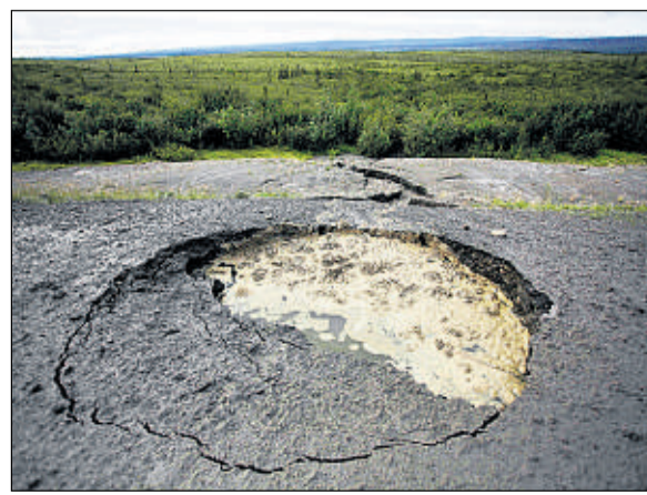
Kaputte Straßen durch Schmelzen von Permafrostböden: Am kanadischen Dempster Highway sind Auswirkungen globaler Erwärmung zu sehen. Foto: AP
